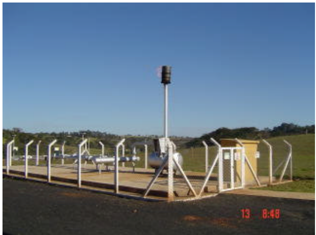
Detalhe de um sistema de queima instalado.
